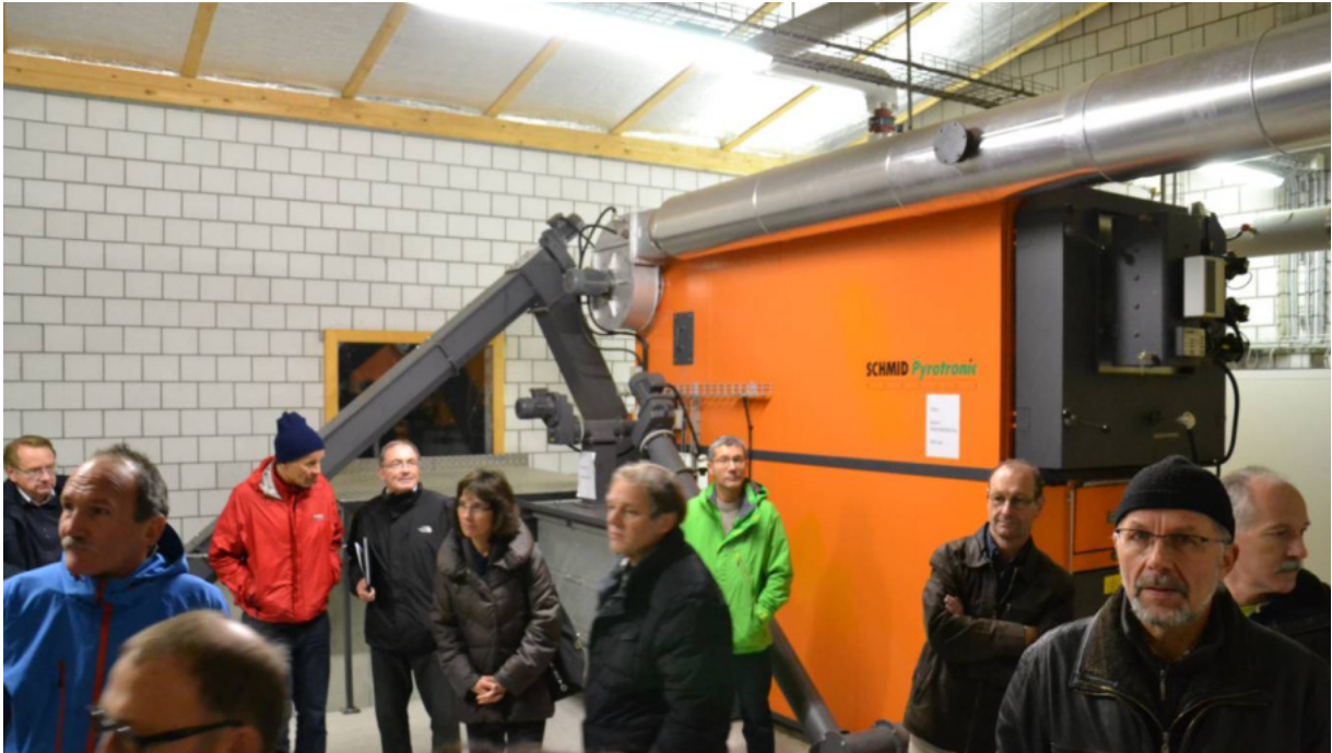
Der Ofen: Zusammen mit der Steuerung das Herzstück der Fernwärmezentrale (Schweizer Qualitätsprodukt)
