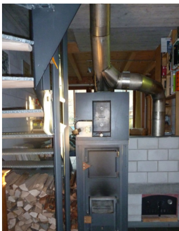
Holzofen im Wohnbereich für Heizung und Warmwasser
